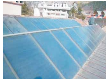
Impianto solare con F-802 a Wolfsburg.
